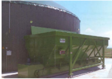
Usine de digestion anaérobie
