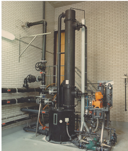
Instalacja odsiarczania biogazu
