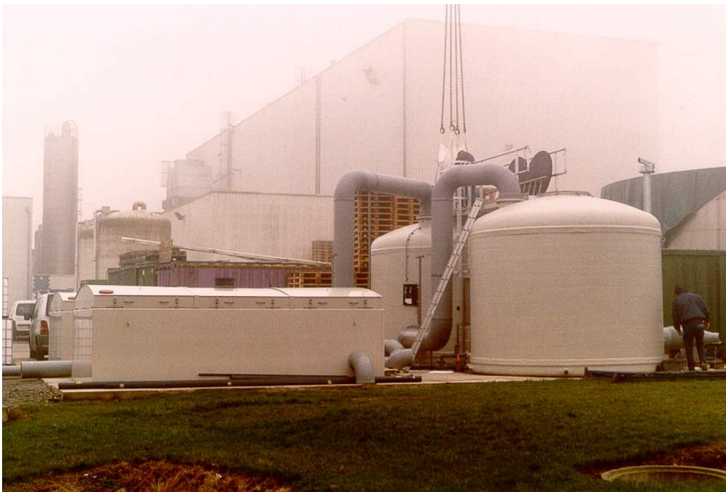
Installation de traitement biologique de l'air à deux niveaux DMT (4000 m 3 /heure) sur le site d'une usine d'épuration des eaux usées en Belgique.
